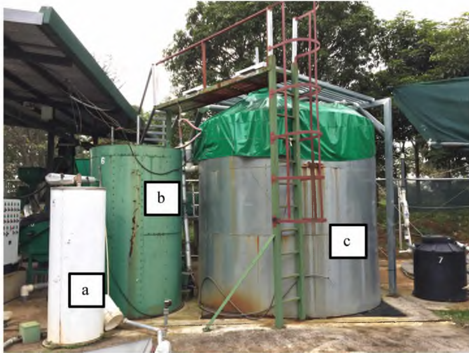
Figura 4. a) Tanque de almacenamiento de energía térmica presurizado, b) tanque de almacenamiento de energía térmica y c) digestor anaeróbico termofilico, del SISTRH en la EEAFBM.
