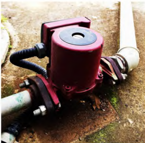
Figura 5. Bomba de recirculación, modelo UP 26-99 F de Grundfos.
