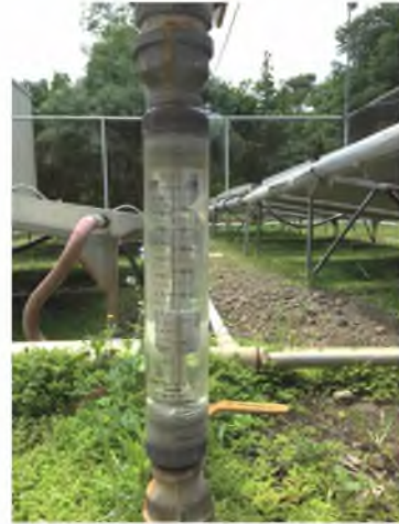
Figura 29. Flujómetro utilizado para medir el caudal de operación de la bomba de recirculación en los colectores solares.
