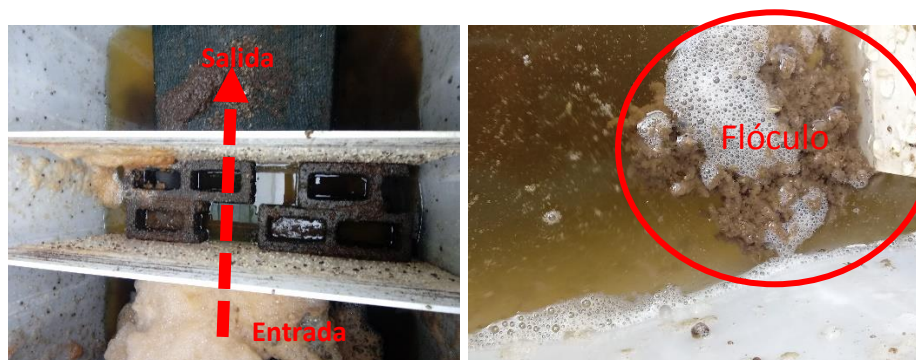
Figura 4-9. Sedimentación de sólidos y formación de flóculos en el tanque de compensación.
