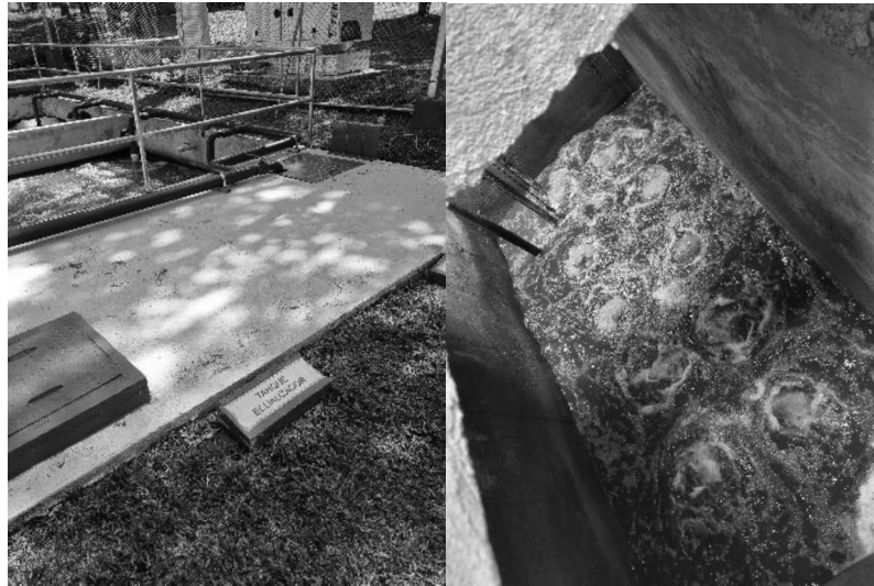
Figura 6. Tanque ecualizador de la PTAR.
