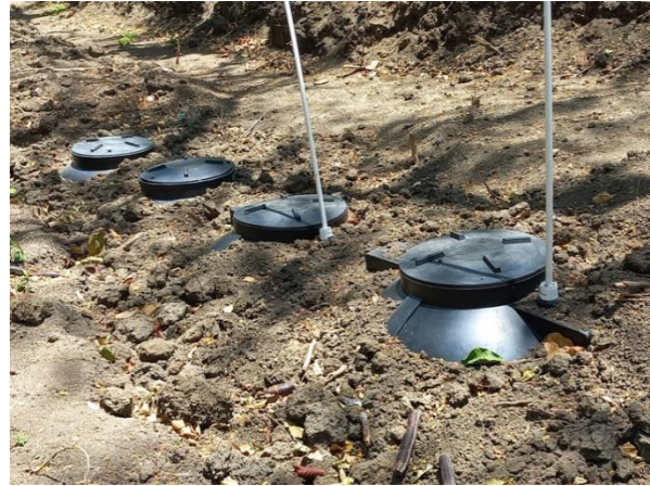
Figura 19. Fosas sépticas para captación de aguas negras
