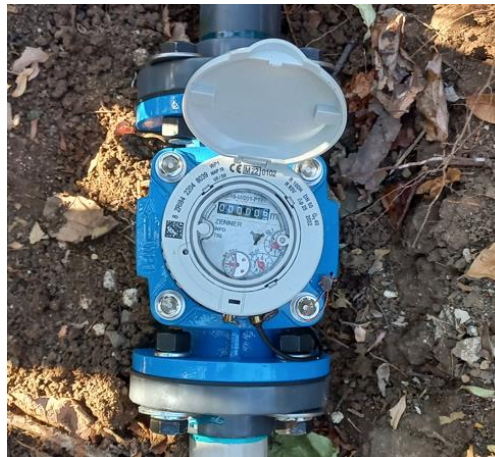
Figura 15. Medidor de agua instalado en el refugio
