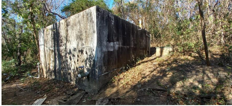
Figura 14. Reservorio de almacenamiento de agua potable
