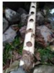
Caso extremo de obstrucción en tubería de entrada
