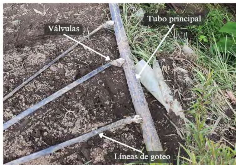
Figura 28. Válvulas de cierre de cada línea
