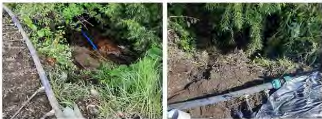
Figura 42. Evidencia de deslaves de terreno en la zona inferior de la parcela
