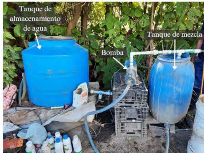
Figura 24. Sistema de bombas, válvulas y conectores que se utiliza del fertirriego de forma manual
