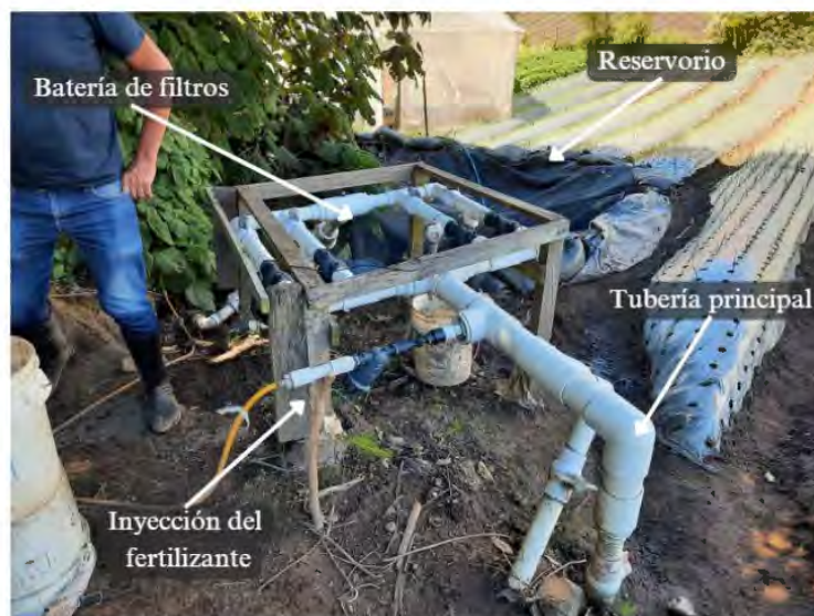
Figura 23. Batería de filtros y Venturi que se utiliza para la inyección del fertilizante
