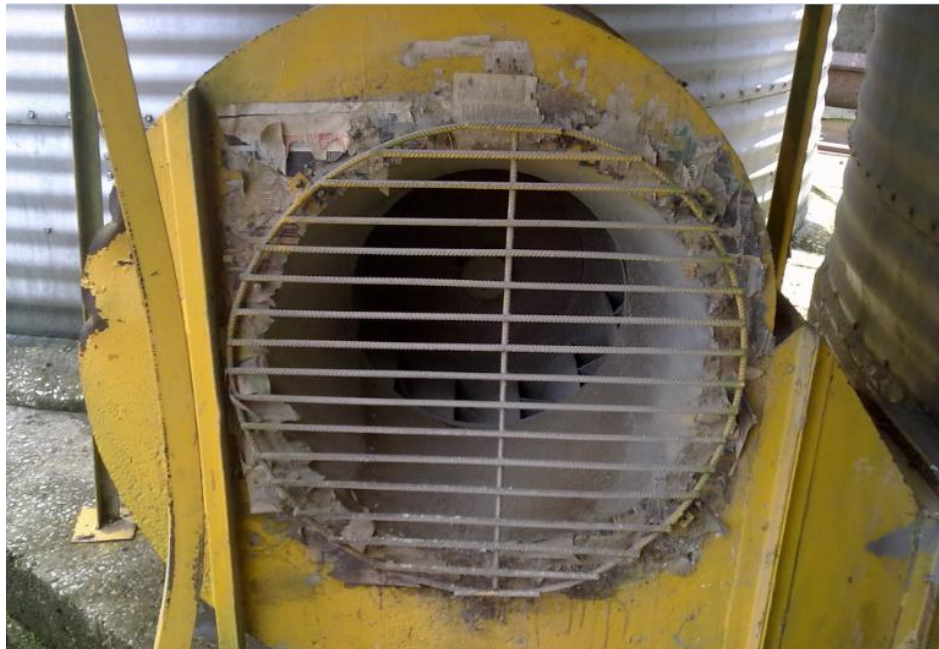
Figura 4.6. Abanico utilizado para aireación del silo experimental
