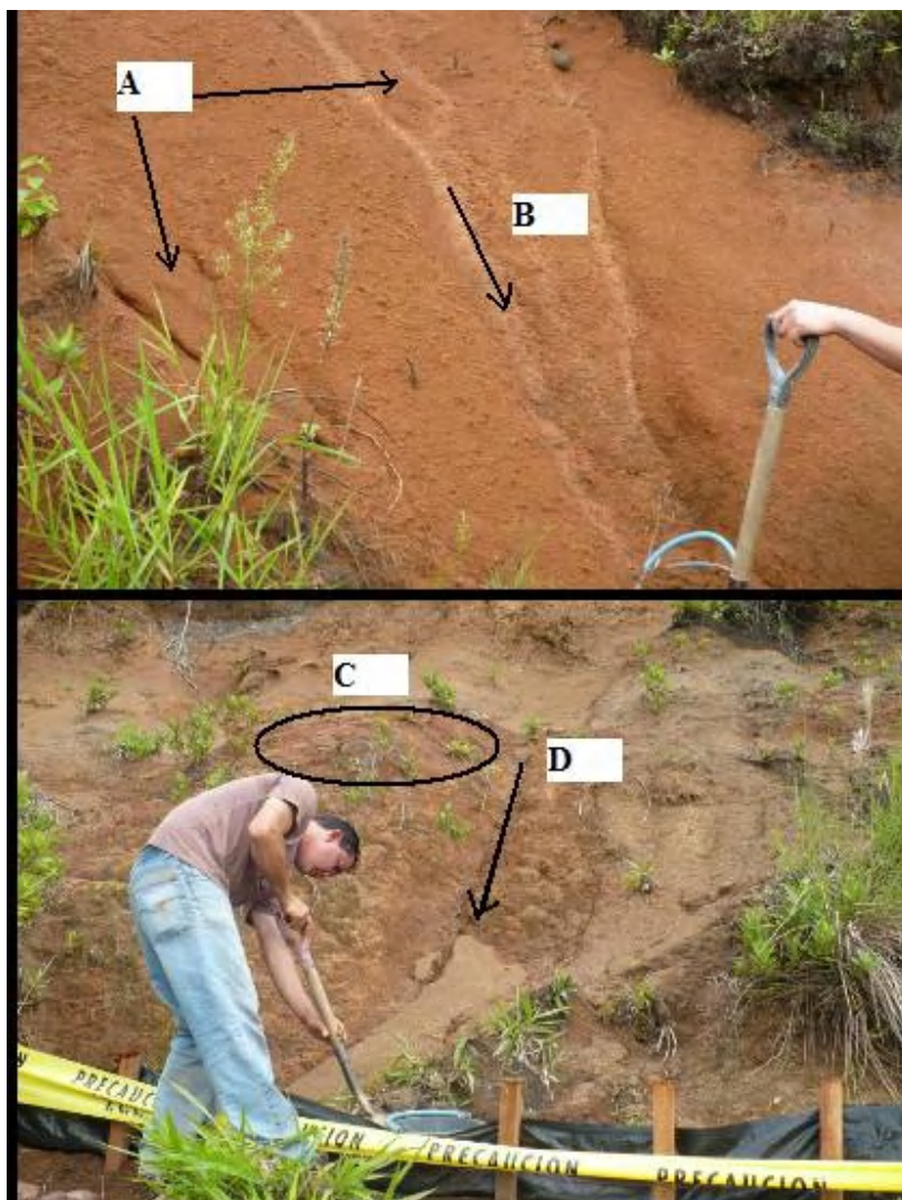
Figura 5.4 Ejemplo del proceso de erosión mostrado en las parcelas de la Ruta N° 926. A, B) Se presenta la formación de surcos y la acumulación de material desprendido durante los eventos de precipitación, los cuales quedan susceptibles. C, D) Durante los periodos secos debido al fenómeno del Niño el material desprendido queda susceptible a la erosión eólica.
