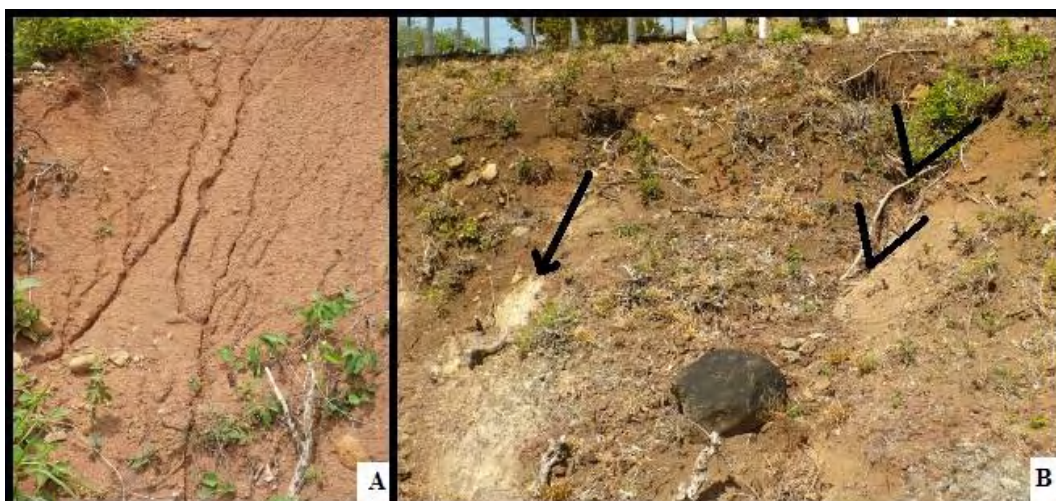
Figura 5.5 Ejemplo de procesos erosivos en los taludes de la Ruta N° 142. A) Formación de surcos entre el material acumulado desprendido producto de precipitaciones anteriores. B) Formación de pequeñas cárcavas. Fuente. El autor.
