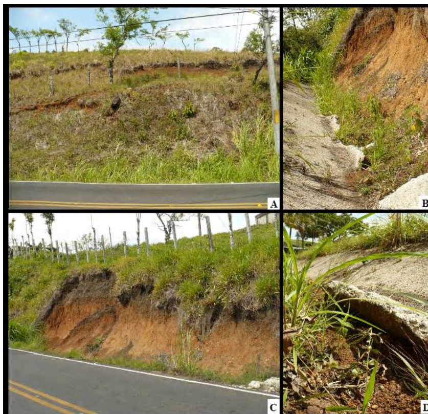
Figura 4.8 Ejemplo del estado de la Ruta N° 142 en el tramo Tilarán-La Fortuna. Fuente. El autor.
