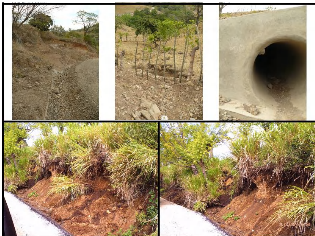
Figura 4.10 Ejemplo del estado de la Ruta N° 925 Líbano-Tilarán. Fuente. El autor.
