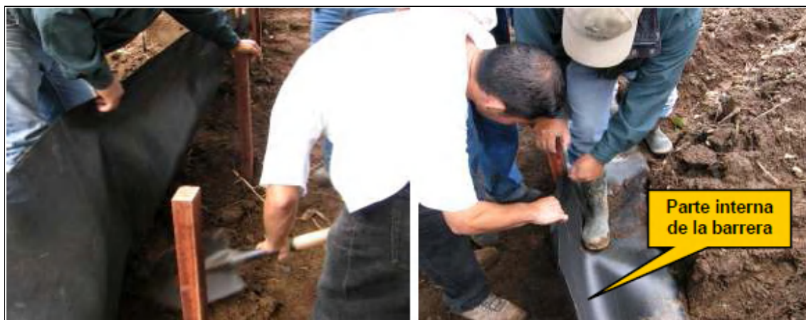
Figura 9. Nivelación del terreno bajo el geotextil y estirarlo para colocar sobre las estacas (Prado, 2007).
