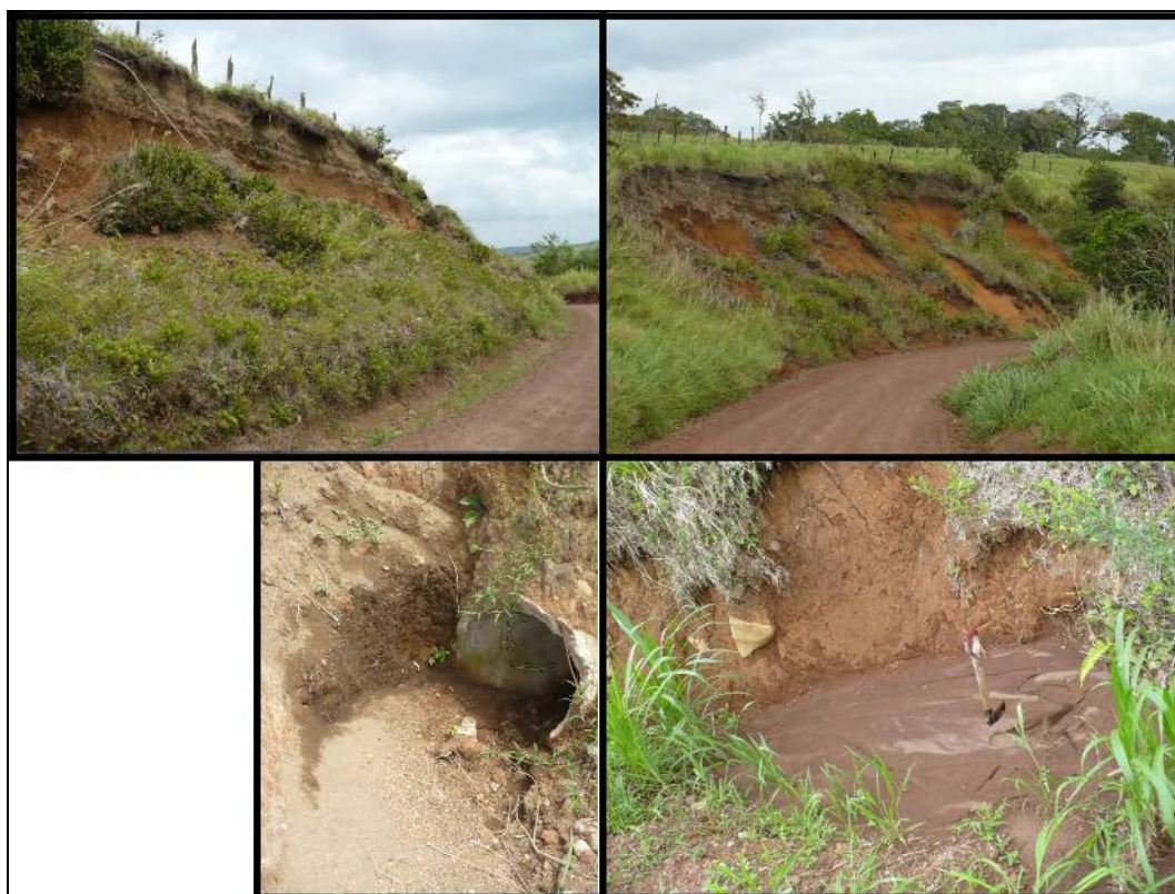
Figura 4.6 Ejemplo del estado de la Ruta N° 926: El Silencio-Tilarán. Deslizamientos de aporte directo a Quebrada Chanchos y río Santa Rosa. Fuente. El autor.
