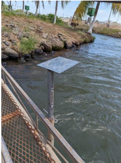
Figura 34. Soporte colocado para la colocación del sensor.
