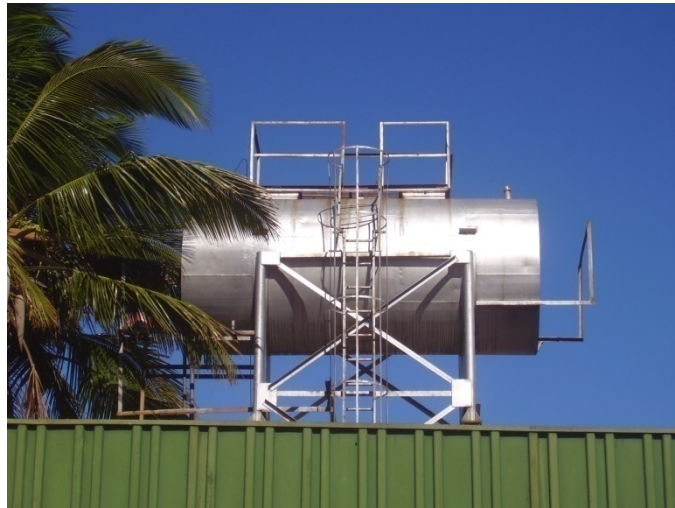
Figura 11. Tanque de Agua de abastecimiento
