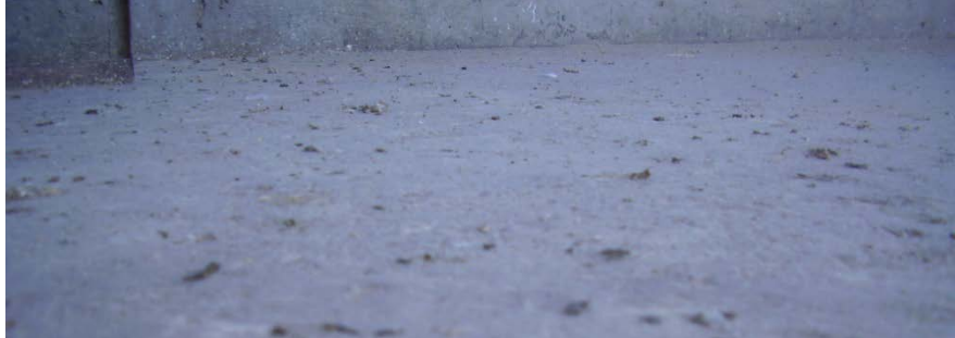
Figura 15. Excremento de paloma acumulado en el suelo de la Planta
