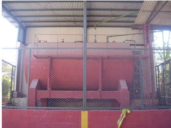
Figura 17. Tanque de almacenamiento de Diesel
