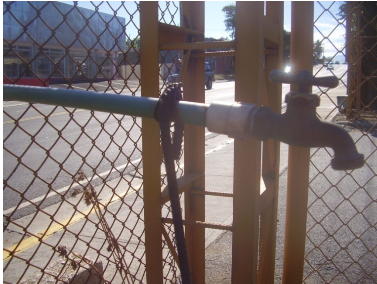
Figura 10. Tubo de Agua potable
